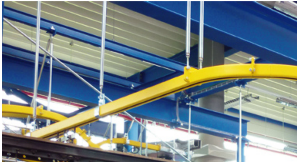
Das Fördersystem der neuen Pulverbeschichtung unterteilt sich in einen Automatikbereich (Vorbehandlung und Trockner) und einen manuellen mit Handschiebebahn.
