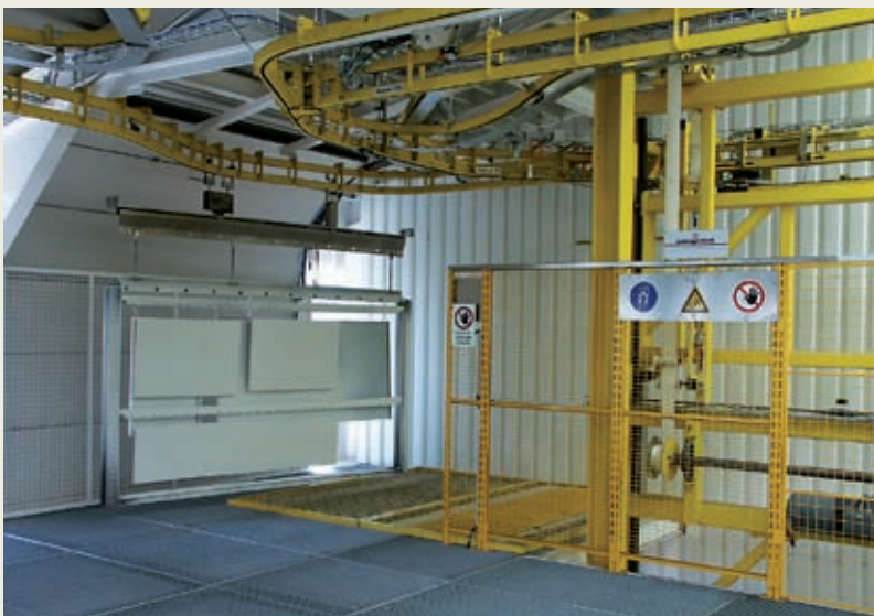
▲ Über einen Lift gelangen die bis zu 3,1 x 1,7 m großen Werkstücke in den ersten Stock zur Montage
