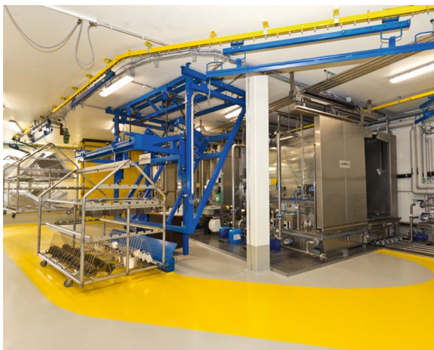
Die moderne Multimetallanlage erlaubt durch den individuell abgestimmten Betrieb eine hohe Flexibilität und Ressourceneffizienz
