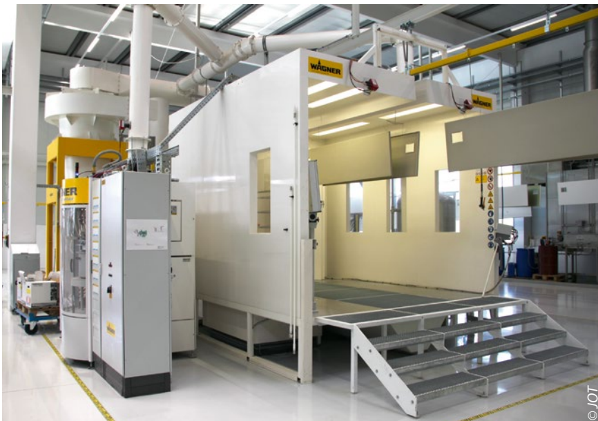
Die Beschichtungskabine mit dem Pulverzentrum. Der Handbeschichterplatz lässt sich vom Automatikbereich lüftungstechnisch entkoppeln. Somit lassen sich im Kurzchargenbetrieb mit reiner Handbeschichtung ohne großen Farbwechsellaufwand mehrere Gehänge mit unterschiedlichen Farbtönen nacheinander beschichten.
