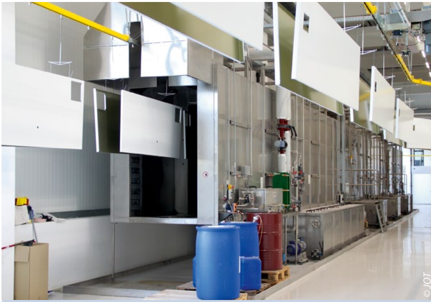
In der Sprüh-Vorbehandlung werden die Teile entfettet, eisenphosphatiert und gespült. Durch die Dreifach-Kaskadenspülung fällt nur sehr wenig Abwasser an.
