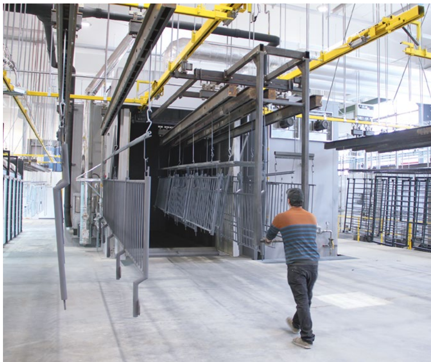
Die Einschubbühne vor dem Einbrennofen ermöglicht eine optimale und flexible Bestückung, unabhängig von der Teilebreite.
